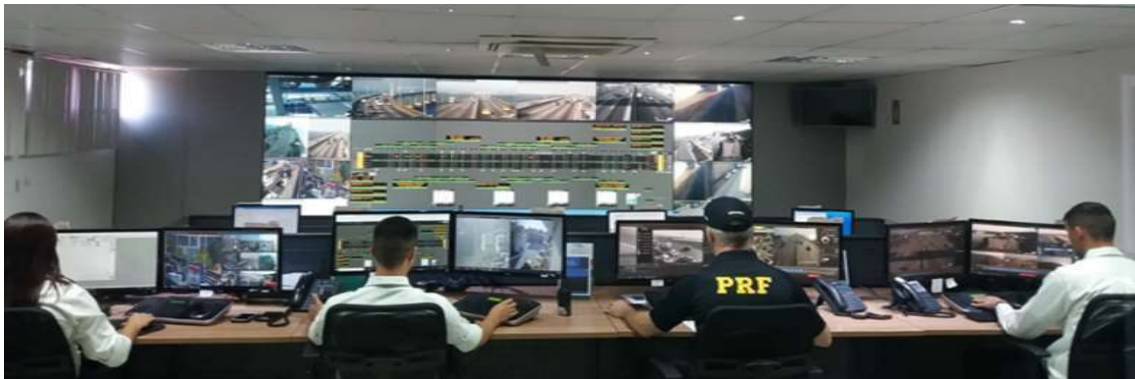
Foto 22 Centro de Controle Operacional – Ecoponte
