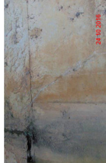
Foto 8. Fissura inclinada na parede da estrutura de encontro Norte.
