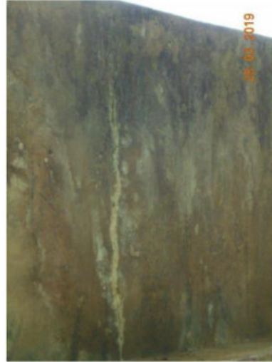
Foto 4. Fissura com efflorescência na laje em balanço.
