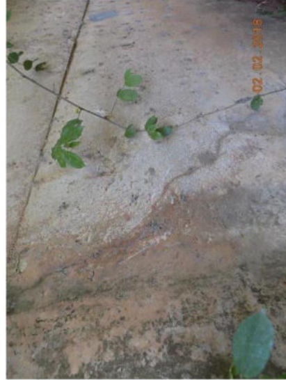
Foto 8. Fissura inclinada na parede da estrutura de encontro Norte.
