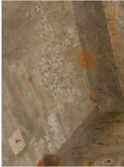
Foto 6. Concreto segregado na laje.
