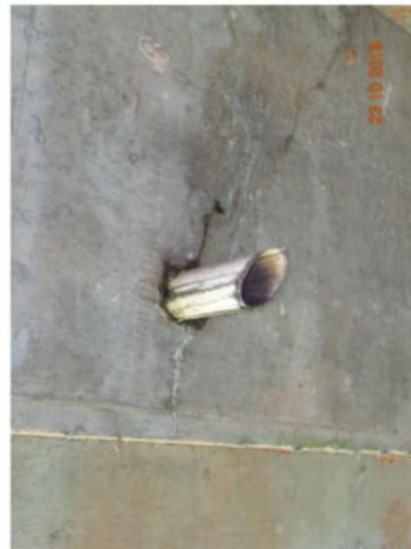
Foto 7. Fissura com posicionamento transversal e abertura máxima de 0,3mm na laje em balanço.
