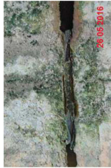
Foto 4. Vista do aparelho de apoio tipo Neoprene. Nota-se que o mesmo encontra-se esmagado.
