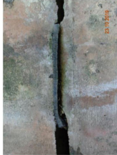
Foto 4. Vista do aparelho de apoio tipo Neoprene. Nota-se que o mesmo encontra-se esmagado.
