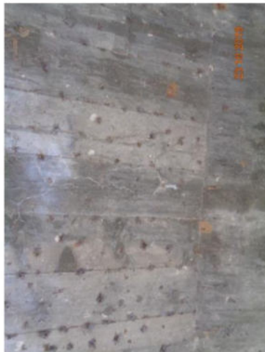
Foto 5. Fissuras aleatórias com efflorescência no painel de laje.
