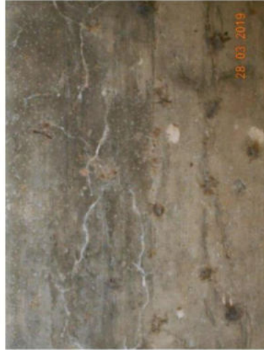
Foto 6. Fissura com eflorescência e posicionamento variado na laje.
