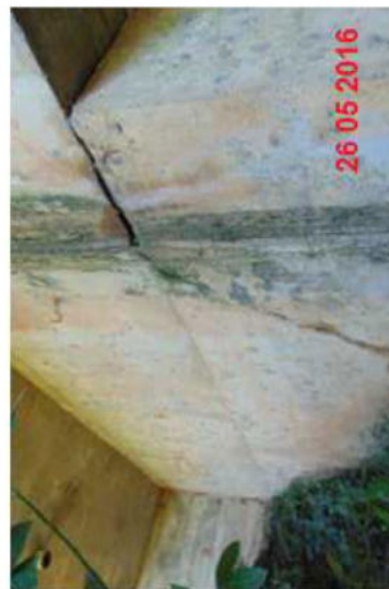
Foto 7. Fissura inclinada na parede da estrutura de encontro Sul.
