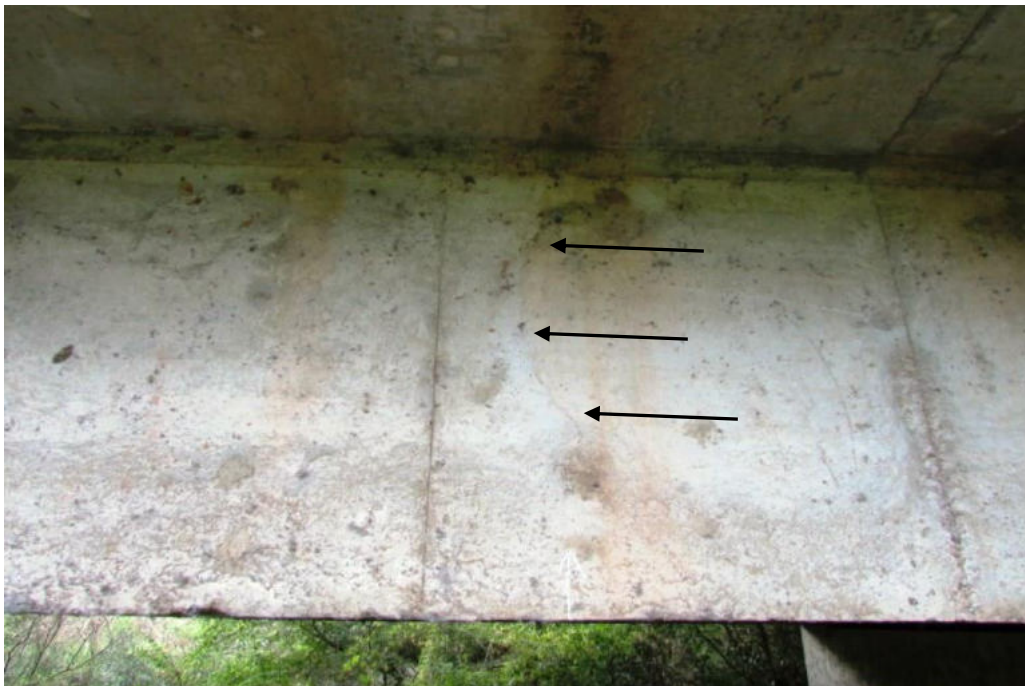
Foto 38 Notar fissura superficial de 0,1 mm na face lateral externa da viga longitudinal VL.01. (Ver setas)
