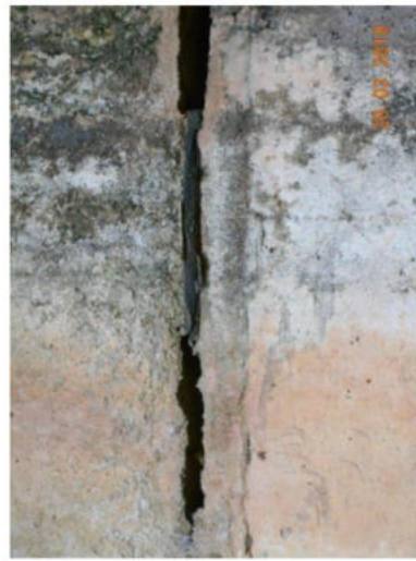
Foto 7. Vista do aparelho de apoio tipo Neoprene. Nota-se que o mesmo encontra-se esmagado.
