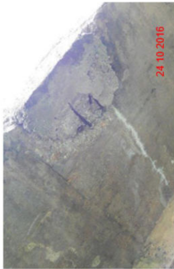
Foto 5. Fissura com eflorescência e concreto disgregado com armadura exposta e corroída na laje em balanço.
