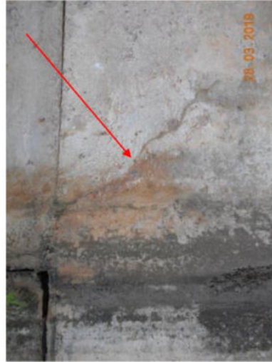
Foto 8. Idem foto anterior. Com detalhe para fissura inclinada na viga travessa.
