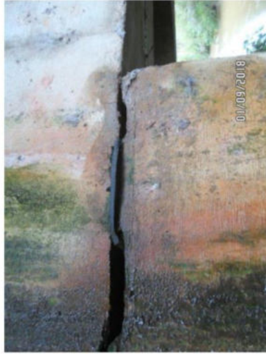
Foto 6. Vista do aparelho de apoio tipo Neoprene. Nota-se que o mesmo encontra-se deformado.
