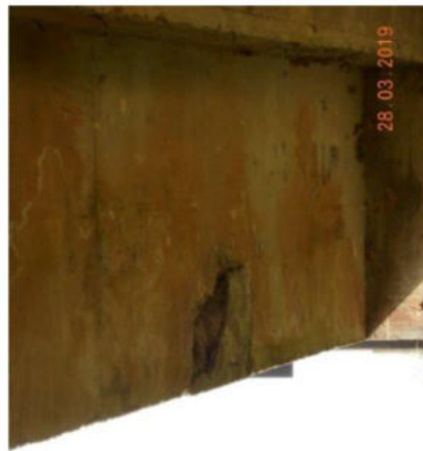
Foto 5. Concreto disgregado com armadura exposta e corroída na laje em balanço.
