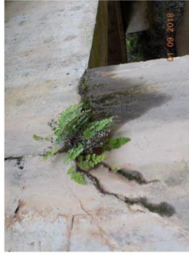
Foto 8. Fissura na mesoestrutura devido a falhas na aparelho de apoio.
