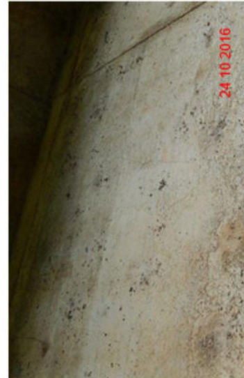
Foto 7. Fissura na parede da estrutura de encontro Sul.
