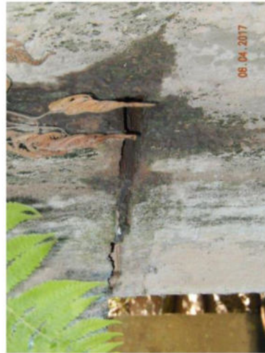
Foto 7. Vista do aparelho de apoio tipo Neoprene. Nota-se que o mesmo encontra-se deteriorado.
