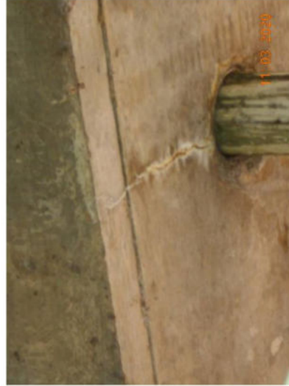
Foto 4. Fissura com efflorescência na laje em balanço.
