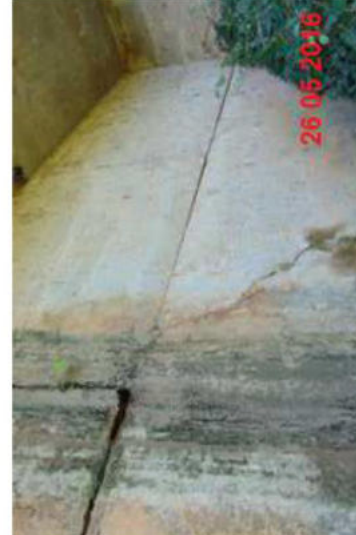
Foto 8. Fissura inclinada na parede da estrutura de encontro Norte.
