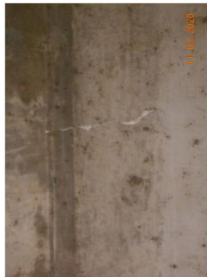
Foto 7. Fissura com efflorescência na viga transversina.
