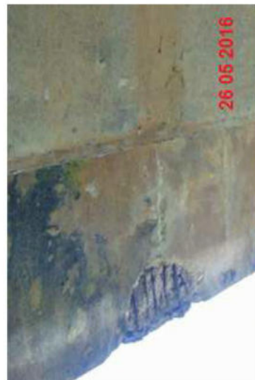
Foto 5. Fissura com eflorescência e concreto disgregado com armadura exposta e corroída na laje em balanço.
