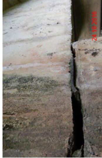
Foto 6. Vista do aparelho de apoio tipo Neoprene. Nota-se que o mesmo encontra-se esmagado.
